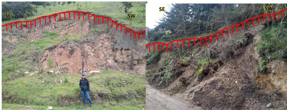
Figura 12. Deslizamiento traslacional suspendido y de detritos y Deslizamiento traslacional de detritos sobre la vía California – Vetas.
